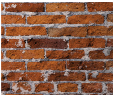
Tehlové murivo po odstránení poškodenej omietky
